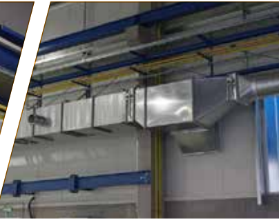
Rohrleitung des PUSH-PULL-Systems
