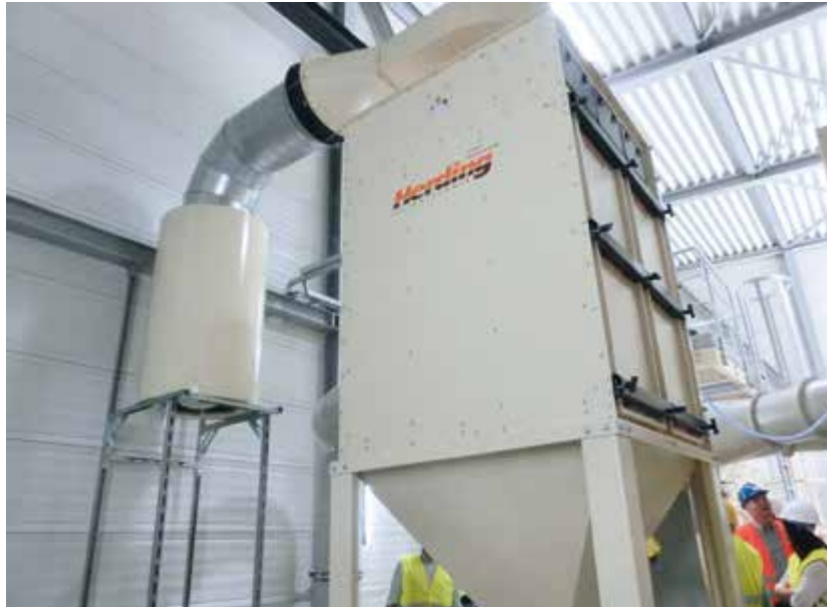
FLEXIBLER EINSATZ: Die Entstaubungsanlage Herding Flex 1500-56/9 GFZ+V sorgt mit ihren Sinterlamellenfiltern für saubere Luft an diversen Stationen im neuen Sand- und Kieswerk. Fotos: Herding Filtertechnik
