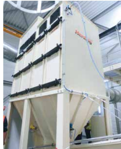
SCHWERPUNKT Mühlen: Zwei Entstaubungsanlagen vom Typ Herding Flex 1500-28/9 GZ+V filtern die Luft an den beiden Mühlwerken.
