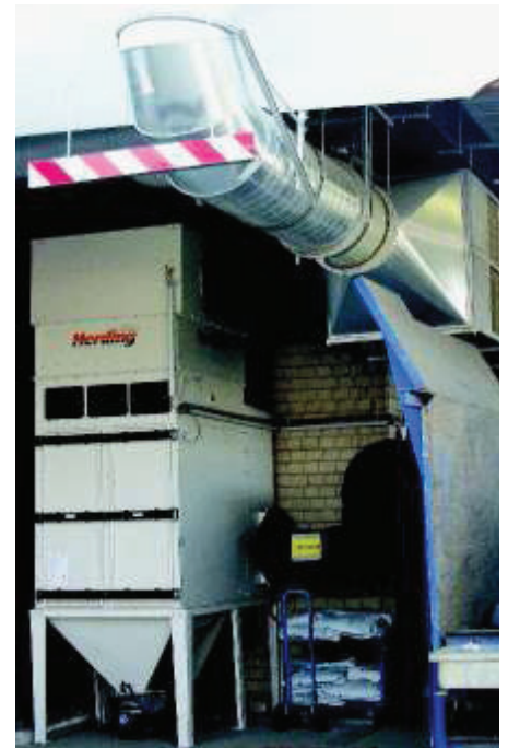
Filteranlage zum Recycling von Elektronikschrott mit Wärmetauscher und Frischluftansaugung über Dach
