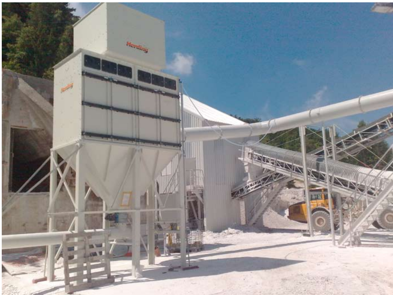
Herding filter system with piping • Herding-Filteranlage mit Rohrleitungen
