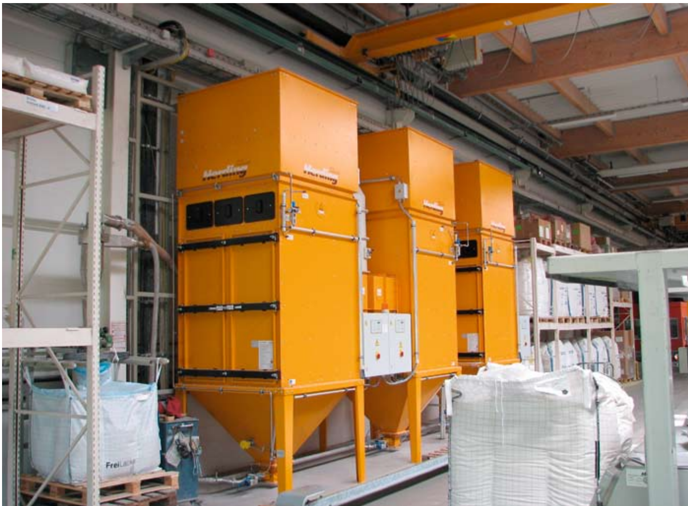
Herding filter system at VG-Orth • Filteranlage von Herding bei der VG Orth
